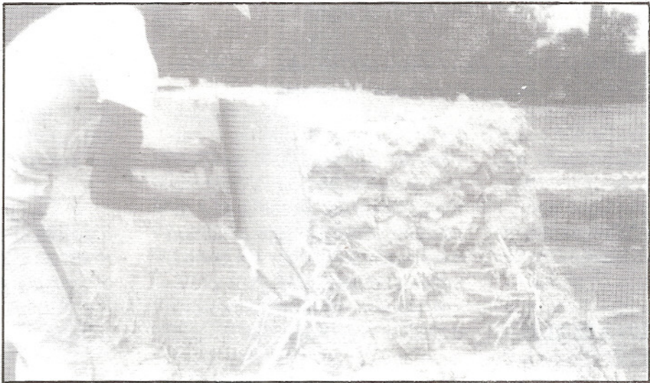
Photo 3 : Construction de mur en argile armé de nattes de paille (Dkhissa, Meknès)
