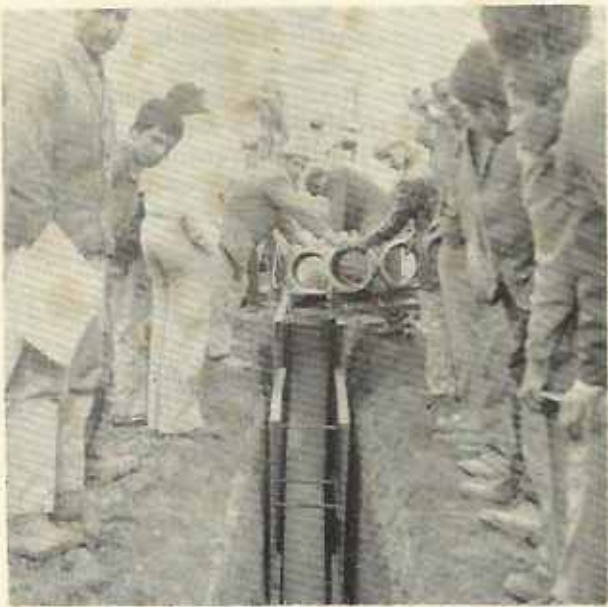
Aperçu des drains
