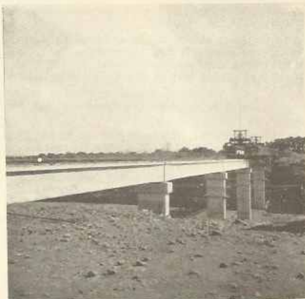
Pont-bache sur l'oued Tessaout. Mise en place de la quatrième poutre au moyen d'un pont Bellow.
