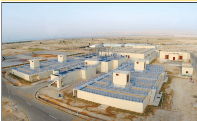
Figure 3: Décanteurs à lit de boues pulsé Pulsatube
