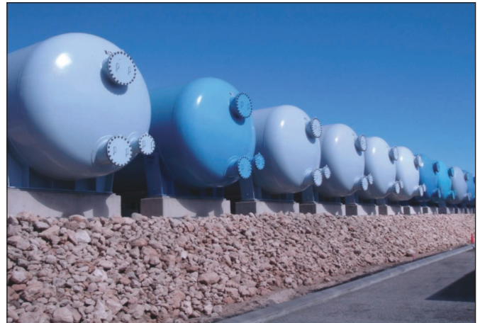
Figure 2: Installation PSDP (Perth, Australie) – Filtres bicouches sous pression Mediazur FH
