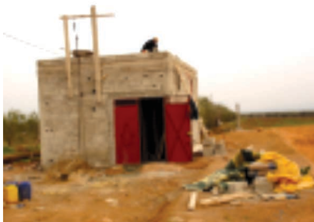
Abri pour une station de tête
