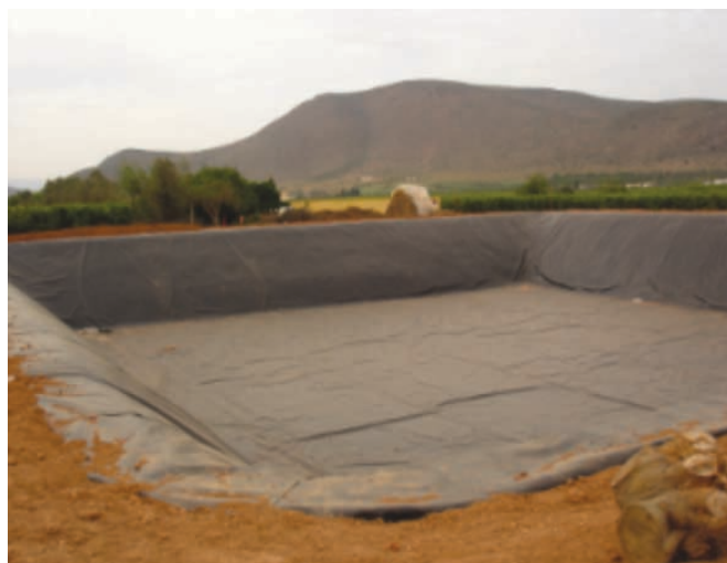
Bassin de stockage couvert d'une géomembrane
