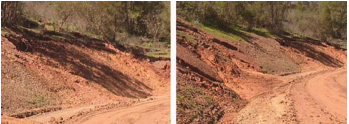
Figure 5: Glissements survenus pendant la construction de la RP 3333 -Mars 2006-
