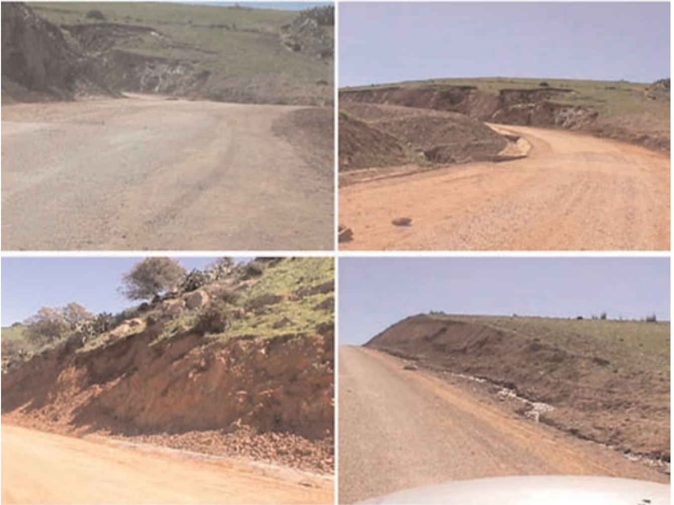
Figure 4: Glissements survenus juste après la construction de la RP 3608 -Mars 2006-
