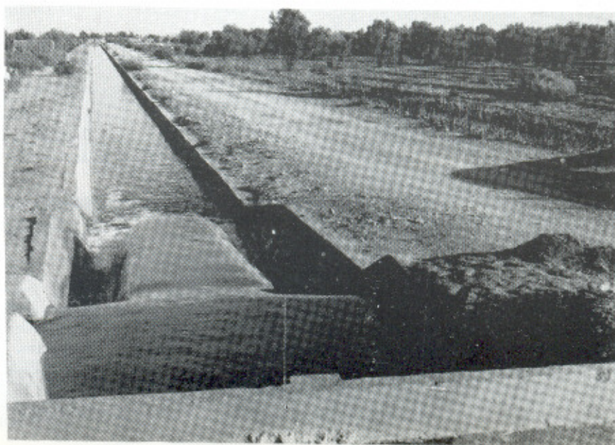
Réseau d'irrigation du périmètre de recasement
